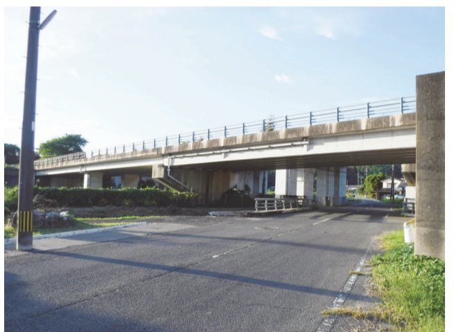
剥落対策を実施する別府川橋
